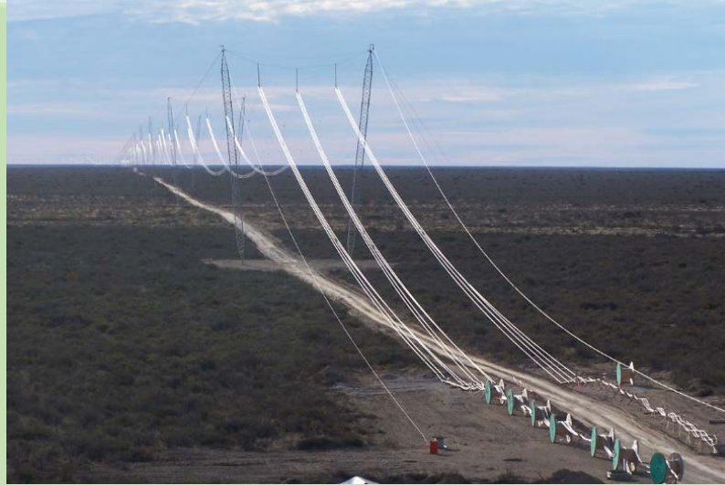
LÍNEAS DE TRANSMISIÓN
